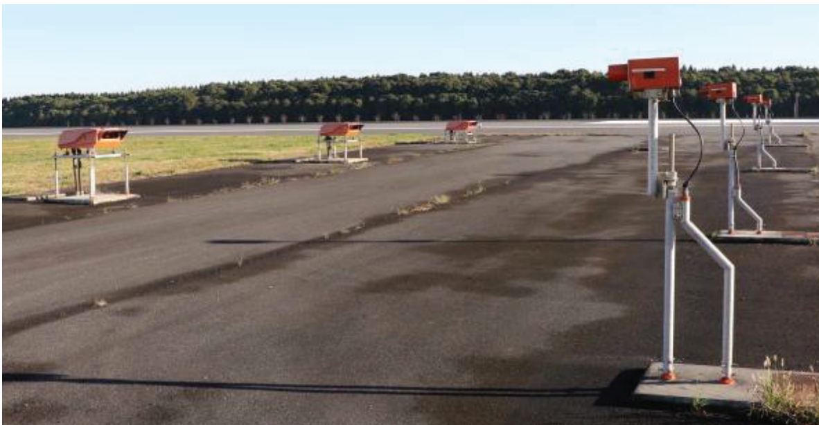
Figure 8-23. Installation de capteurs de surveillance automatique Photo : Aéroport international de Narita
